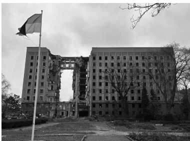
Здание Николаевской государственной областной администрации, разрушенное 29 марта 2022 года и до сих пор не восстановленное. Фото: ЦЗПЧ «Мемориал», 21.01.2025
